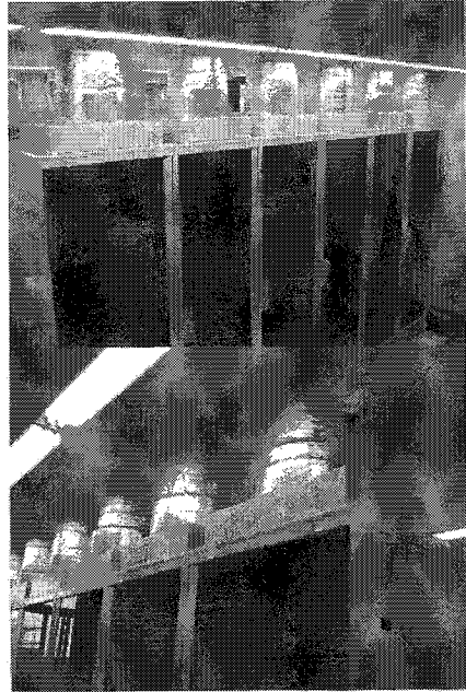
図 11 ラックへのダクト接続 Fig.11 Duct Connection to Racks
