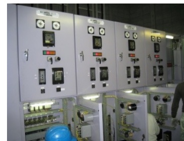
図 7 受電室の様子
