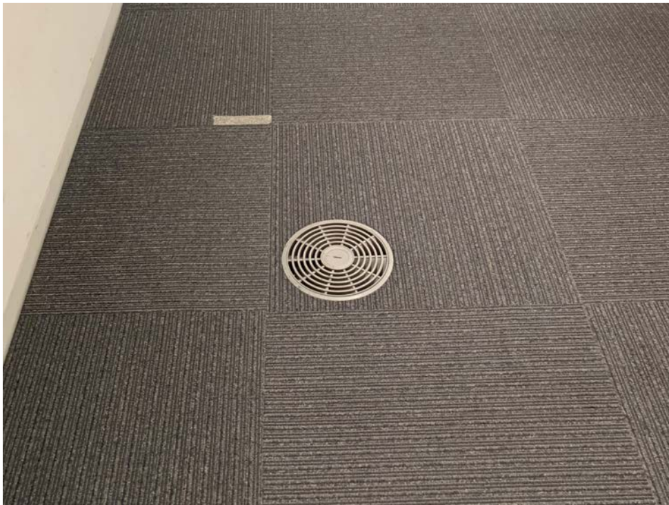
図8 床吹出口（直径約230mm）
