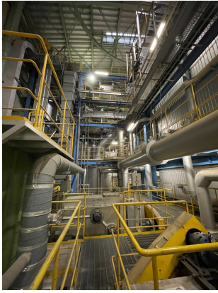
図 1: 石川北部 RDF センターの炉室内部
