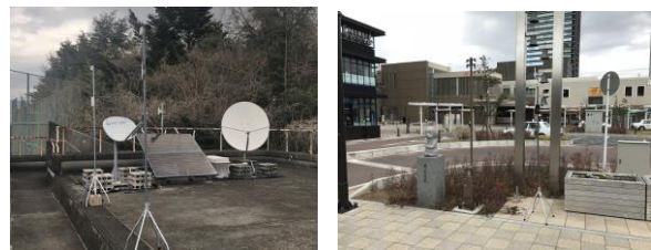
1)自立型防災通信ステーション 2)LPWA送信地点の例
