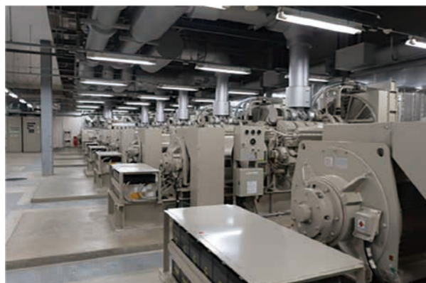
図-1 石狩データセンター 1 号棟の非常用発電設備
