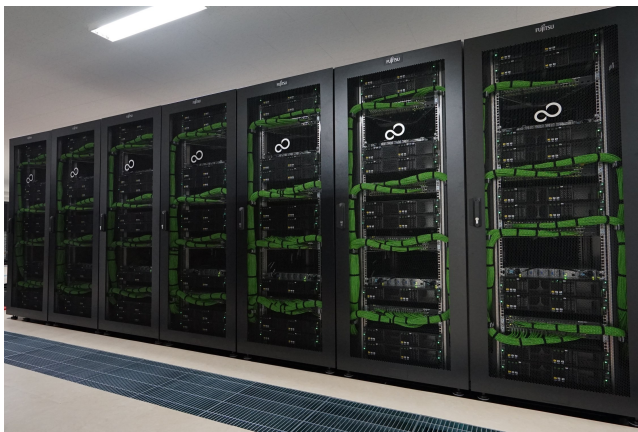
図 2 ITO システム (バックエンドサブシステム B) の外観
