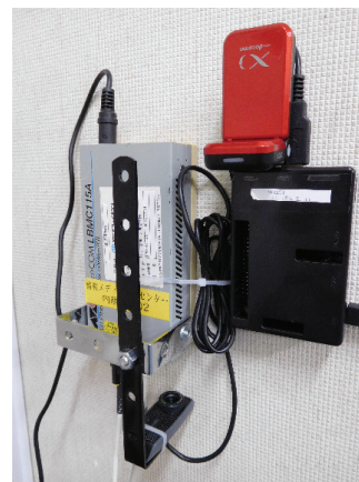
図4 メディアコンバータ監視システム
