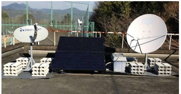
図2 増設した自立型防災通信ステーション
