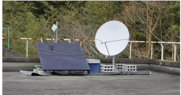
図1 初期の自立型防災通信ステーション
