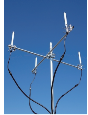
図3 基地局アンテナ
