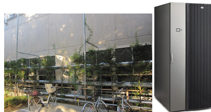
図 3 (左) 屋外に設置されたチラーの様子。(右)Thin 計算ノードを 30 台格納する MCS ラック。
