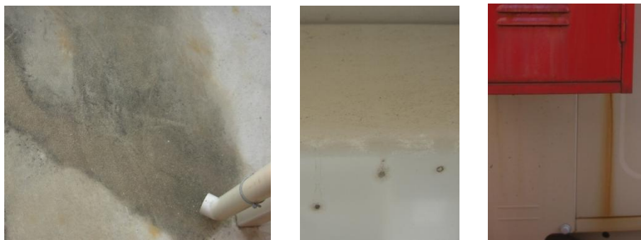
図1 雨による汚れの例
