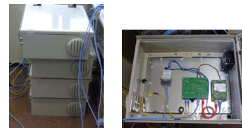
写真5. 加入者集線装置の外観と内部
