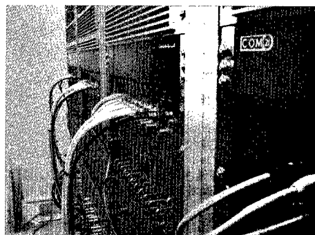
図-2 CATVインターネット用ヘッドエンド装置
