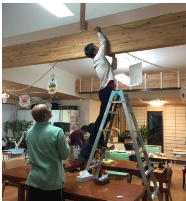
図4 ビーコンスキャナの設置（天井付近の梁）
