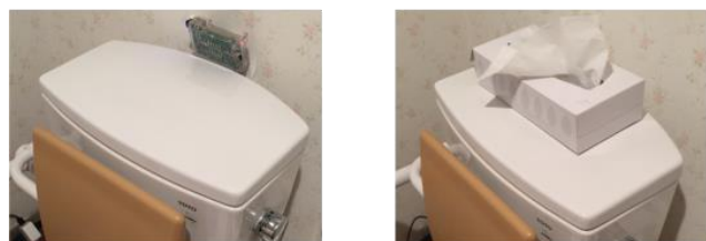
図5 ビーコンスキャナの設置（トイレエリア）
