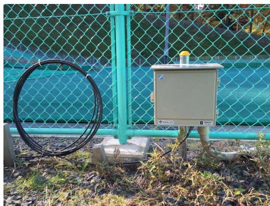
図4 防水函に収納したWiFiアクセスポイントと光メディアコンバータ Fig. 4 WiFi AP and Optical Media Converter Stored in a Waterproof Box
