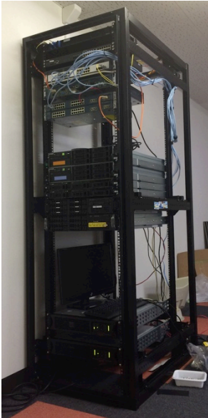
図4 EIA規格19インチサーバラックと学生が搭載したネットワーク・サーバ機材一式
