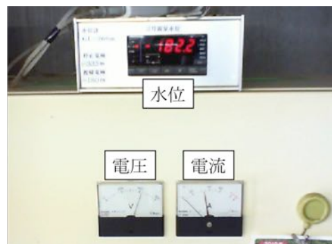
(a) 電圧・電流・水位を示す計器
