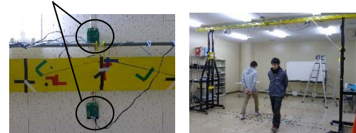
(a) 天井に設置した装置 (b) 通行の様子
