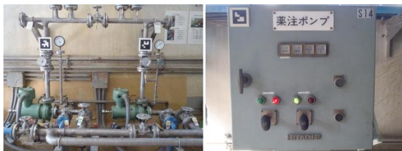
図3 ポンプ設備と操作盤の写真
