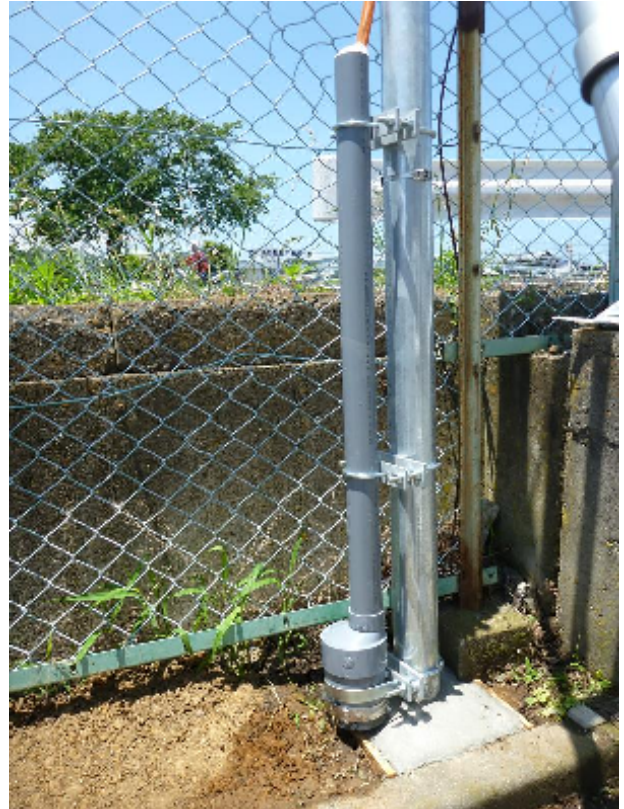
図3 水位センサ IC タグ(現地設置状況)
