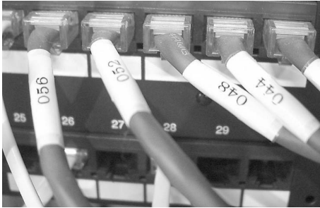
図 1 ラベルづけされたケーブル Fig. 1 Cables labeled by numbers.
