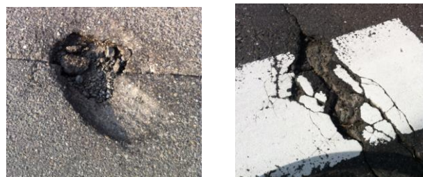
図 12 観測した異常箇所
