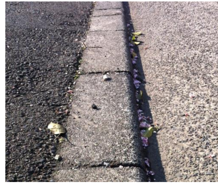
図14 歩道と車道間の段差
