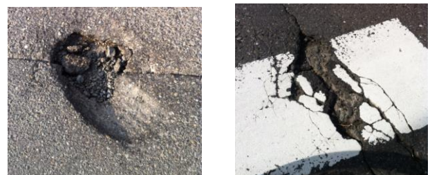
図 12 観測した異常箇所
