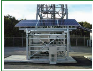
無線機と太陽光の一体架台
