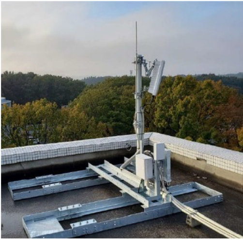
図3 屋上に設置したアンテナの様子
