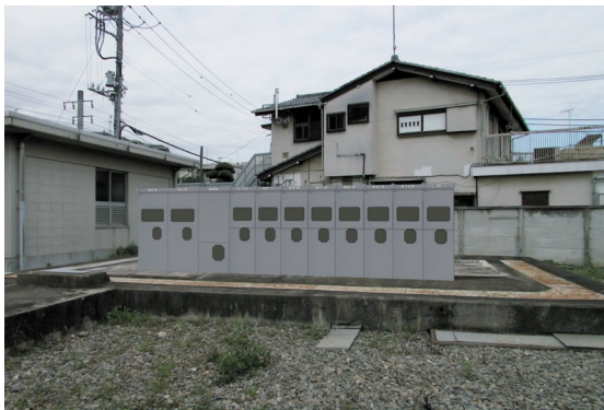
(a) 電力設備 (フォトモンタージュ) 汚れなし
