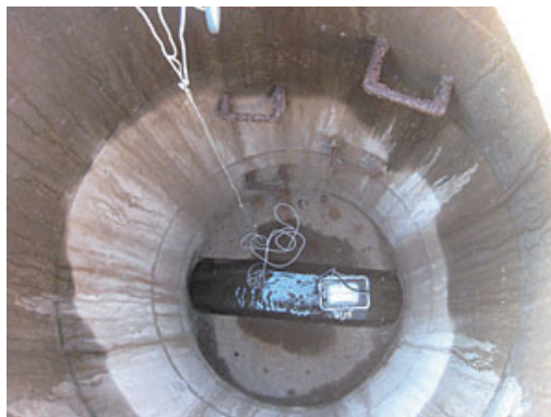
図 10 下水道管きよにおける実験風景：端末の配置
