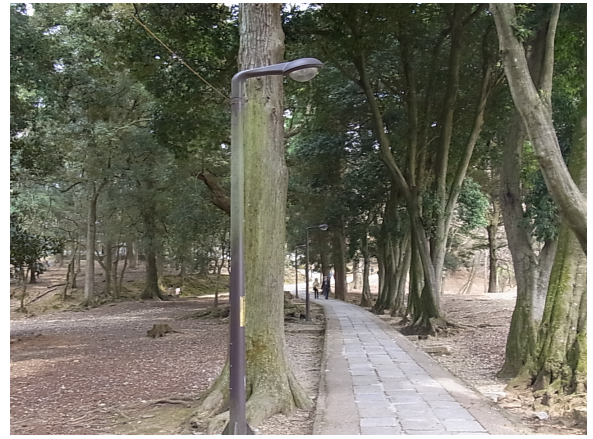
図 5 電灯間の空中配線
