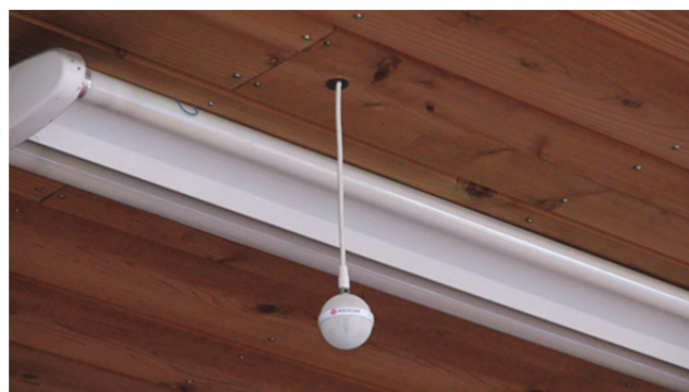
図4 教室に設置したシーリングマイク
