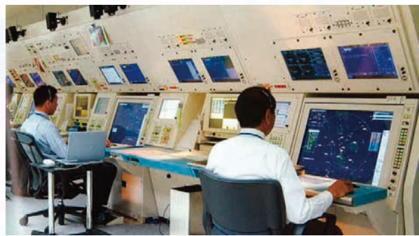
図-6 ターミナルレーダ管制所 4)
