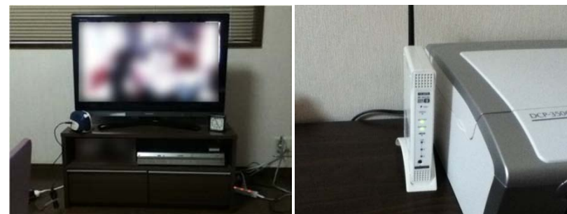
図 10 システムの設置例
