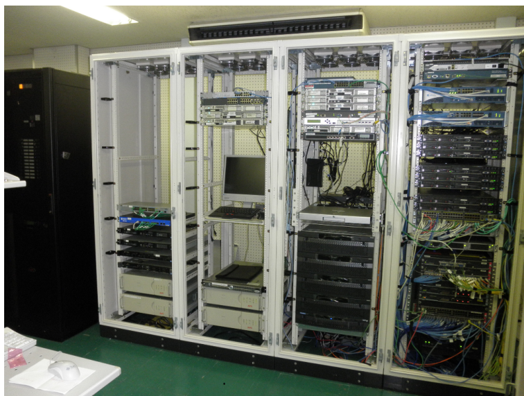
図 3 計画停電時に稼働続けるシステム。左端の黒い筐体が外部電源により給電できる無停電電源装置。右側にコアスイッチがある
