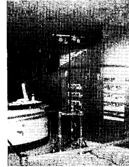
図 9 ロビーに設置されたベクトルセンサ
