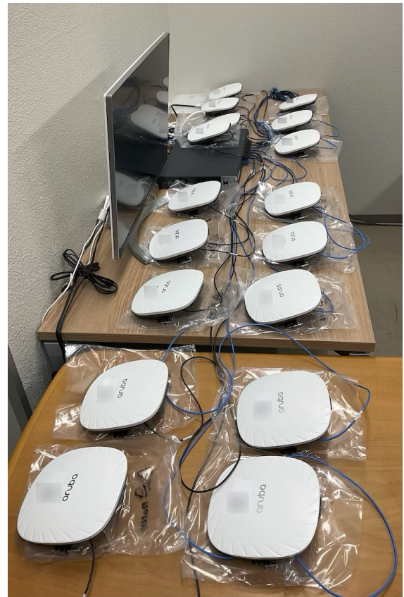
図 6 細径 UTP ケーブルによる接続 Fig. 6 Using thin UTP cable.
