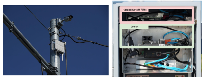
図 7 (左) 信号機の柱上部に取り付けられた監視カメラ, (右) 信号機の柱下部に取り付けられたコントロールボックス
