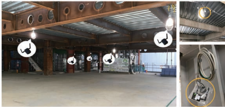
図4 ゲートウェイ設置状況
