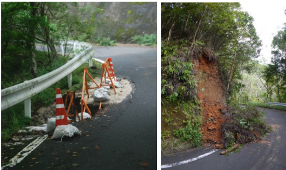
図 1 災害時における道路の被害
