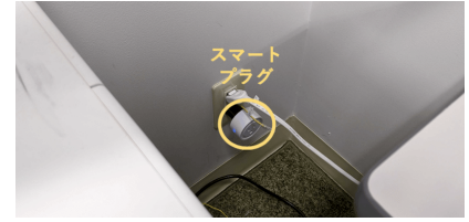
(c) 設置したスマートプラグ
