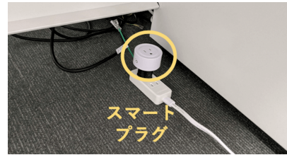
(e) 地点6 に設置したスマートプラグ
