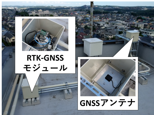
図 2 東京高専情報工学科棟屋上の RTK-GNSS 基地局
