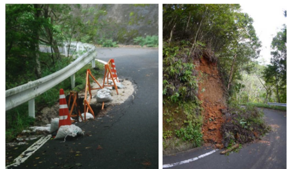
図1 災害時における道路の被害
