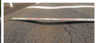
図2: 轍掘れのある道路の例
