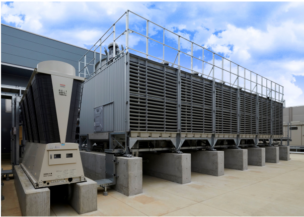
図 4 屋外冷却設備 (左:チリングユニット, 右: 冷却塔)
