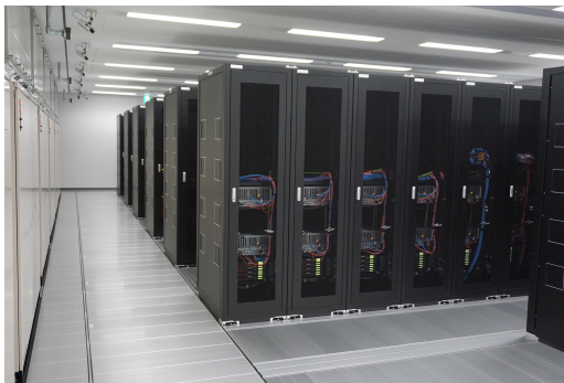
図 2 MN-1 設置状況
