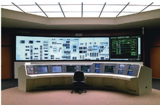
図-1 発電所の中央制御室の例（三菱電機）
