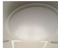
天井照明 (リビング)
