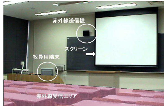
図 3 授業支援型 u-Learning システムの設置例 Fig.3. An example of setting of this system
