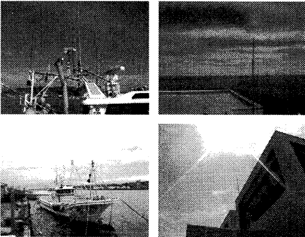
写真 2 無線 LAN アンテナの設置状況
