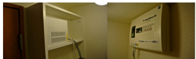
図.5 機器消費電流波形蓄積サブシステム設置状況
