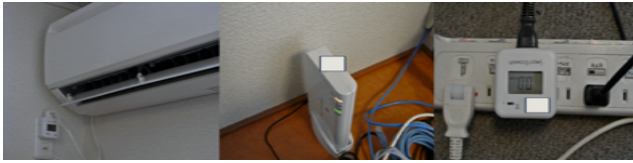
図.6 機器運転履歴収集サブシステムの設置状況
