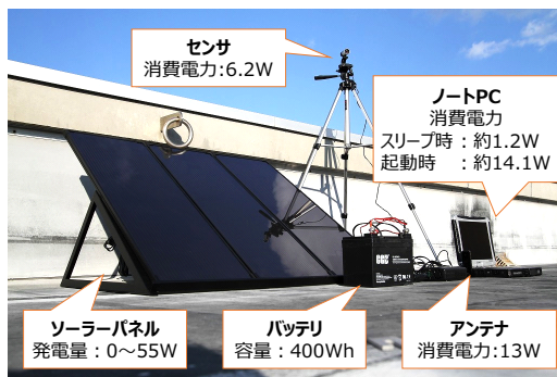
図 1 モニタリングシステム
